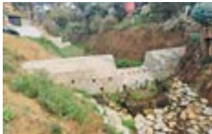
Trampas de agua. Obras de mejoramiento red de aguas lluvia. Valparaíso (MOP, 2021)
